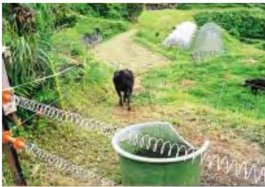
図2.45 法面の縦方向に牧柵を設置すると、牧柵に沿って降りるとき法面を崩す。
