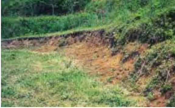
図2.66 崩壊した法面
