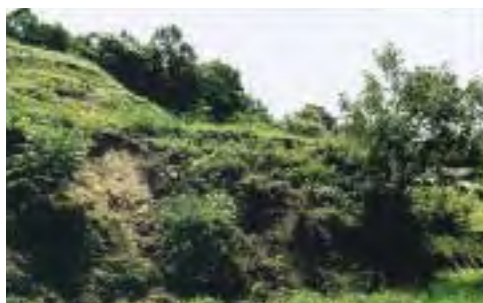
図2.52 法面上にある灌木が原因で崩壊した法面
