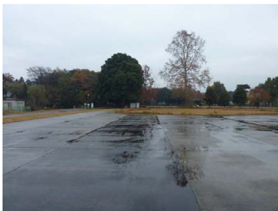
図 22 降雨時のコンクリート路面の状態
