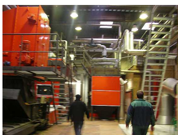
図31 温水供給センター内部
