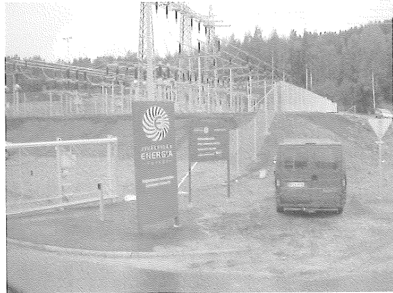
図 20 バイオマス発電所 (入口)
