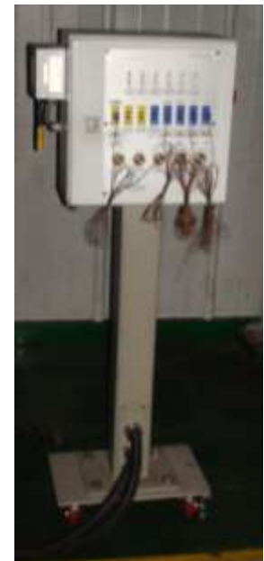
図 2-2-3 熱電対用現場中継盤
