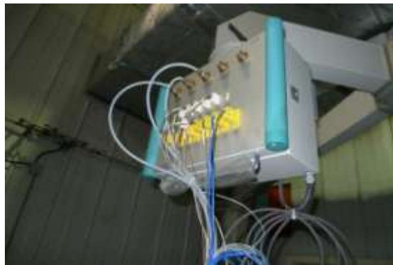
図 5 熱電対端子台
