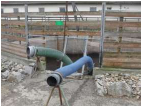
図 13 メタン発酵消化液の貯留池
