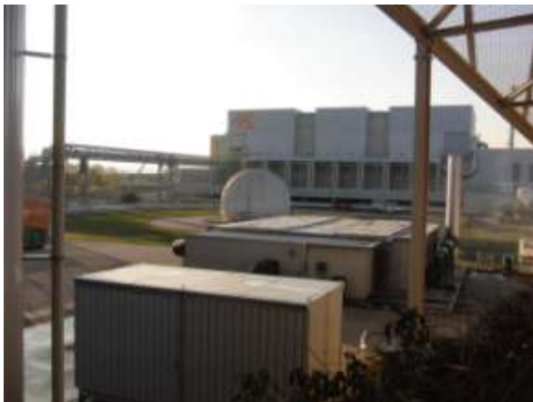
図 19 生ゴミバイオガス発生プラント
