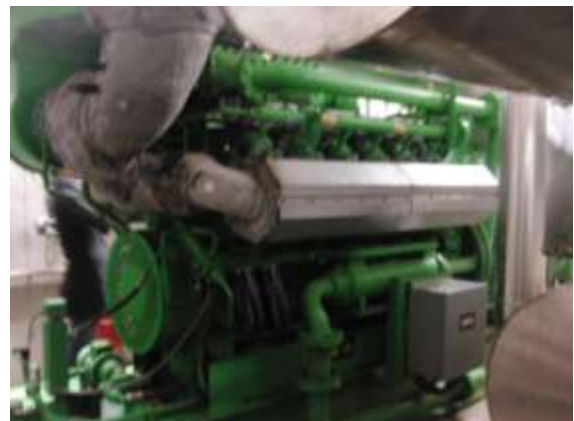
図 10 CHP ガスエンジン
