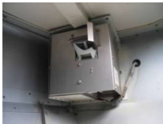
図2 グレンタンク内に設置した水分計
