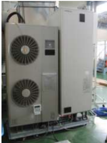
a) ヒートポンプ給湯ユニット
