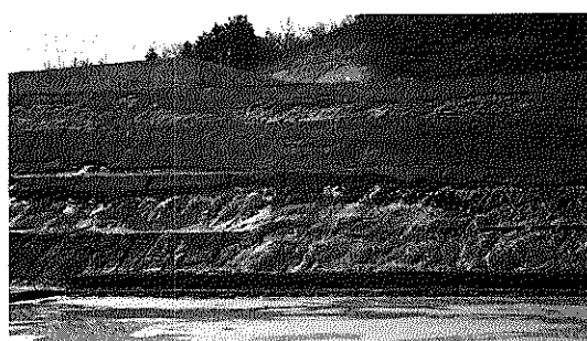
Photo 20 浸透水により侵食された盛土法面 Eroded embankment slope by seepage water
