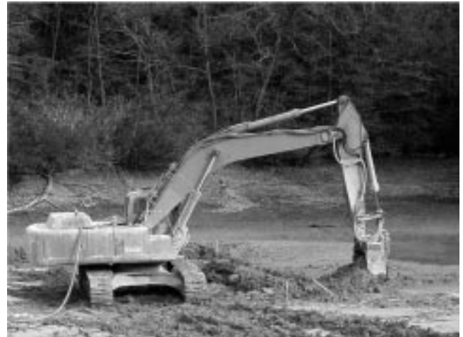
Photo 3 トレンチャー式攪拌混合機による原位置初期固化状況の例 Example of in-situ initial stabilization by trencher-type mixing machine
