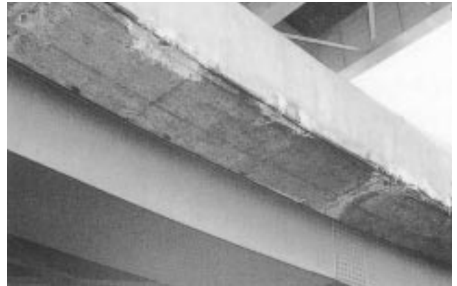
Fig.4 中性化を受けた橋梁の例 Neutralization of bridge
