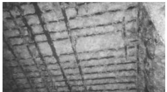
Fig.6 化学的腐食を受けた下水道施設の例 Chemical corrosion of sewerage
