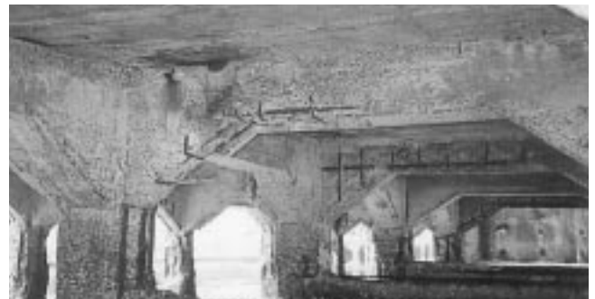
Fig.5 塩害を受けた港湾施設の例 Salt damage of pier
