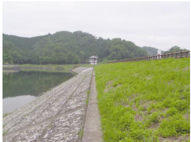
Fig.21 倉橋ダムの改修後の堤体上流側の状況 Upstream view of Kurahashi dam
