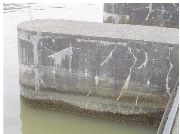
Fig.2 排水機場除塵橋のコンクリート (屋外コンクリート) Guide wall at the pump station
