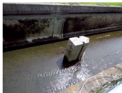
Fig.18 沈下した水路に敷設された 角落とし構造物 The intake weirs installed in subsidence canals to keep water level
