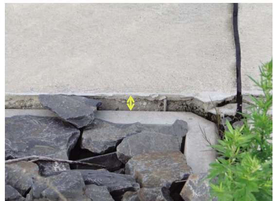
Fig. 27 コンクリートとブロックとの段差景 Difference in level between the concrete and the block
