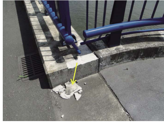
Fig. 37 管理橋のコンクリートの剥落 Dropped concrete from maintenance bridge
