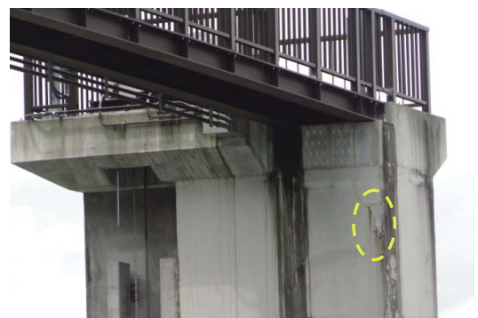
Fig. 63 表面被覆工の上に浸み出した錆汁 Rust fluid out of surface coating
