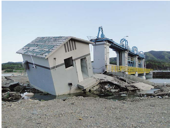
Fig. 13 洗掘により傾倒した管理棟 Tilted administration building by scour
