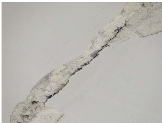
Fig. 93 ひび割れの拡大 Macrograph of the crack
