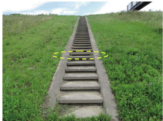
Fig. 38 堤防のコンクリート階段が折損 Breakage of concrete stairs on the bank
