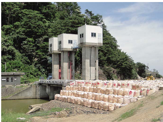
Fig. 15 右岸堤防の喪失および土嚢による復旧 Scoured and restored with sandbags at right bank
