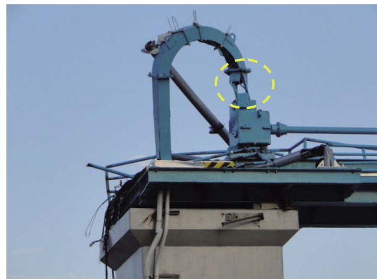
Fig. 79 左岸ラックカバーのねじれ Twisted rack cover on the left bank side
