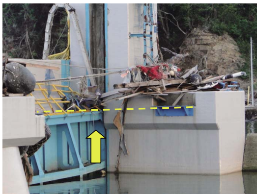
Fig. 77 右岸側ゲートの傾斜および下部管理橋の落橋 Inclined right side gate and dropped lower maintenance bridge
