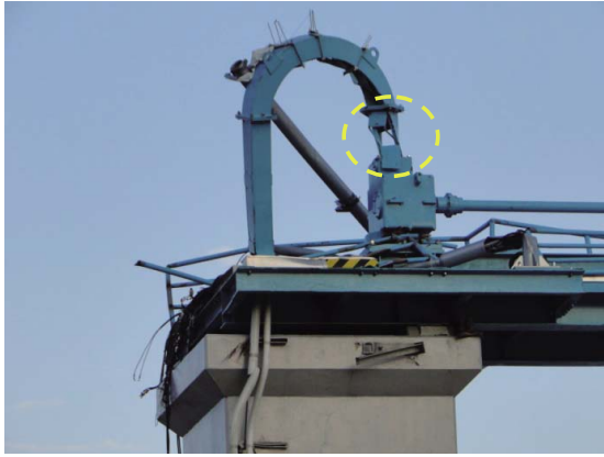
Fig. 8 ラックカバーのねじれ Twisted rack cover
