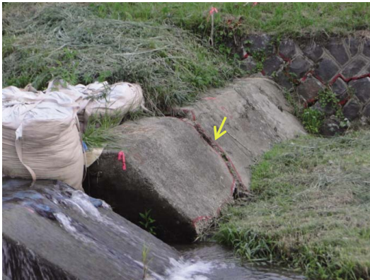
Fig. 47 固定部の破損 Cracked concrete
