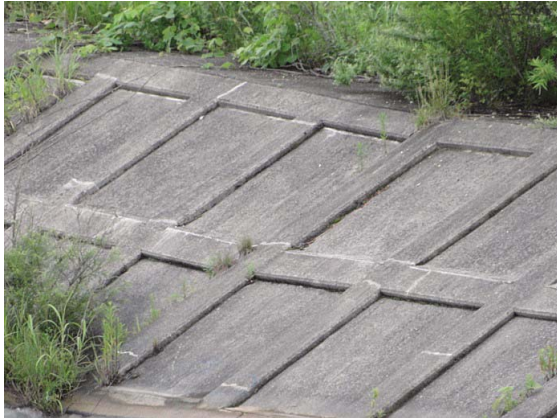
Fig. 18 左岸護岸ブロックのひび割れ Cracks on left bank protection block
