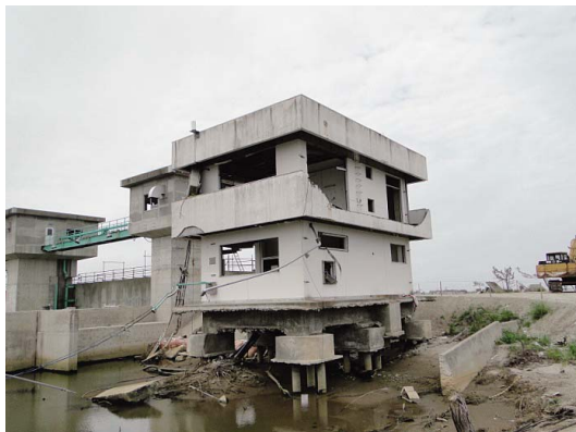
Fig. 106 洗掘により露出した管理棟の基礎杭 Exposed piles of administration building by scour
