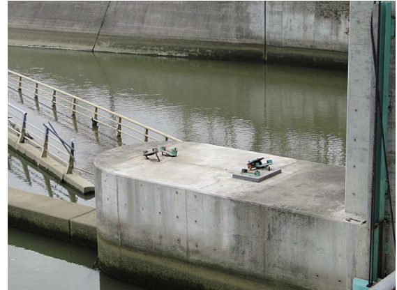
Fig. 10 陸側へ落橋した下部管理橋 Dropped lower maintenance bridge toward land direction
