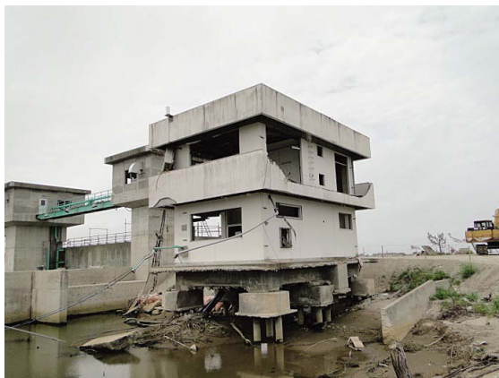
Fig. 14 洗掘により露出した管理棟の基礎杭 Exposed piles of administration building by scour
