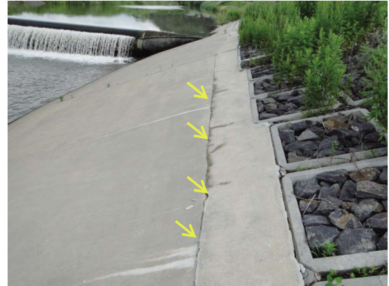
Fig. 26 コンクリート打ち継ぎ目のひび割れ Cracks of concrete joint
