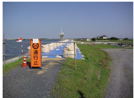
Fig. 70 北割排水機付近の堤防の沈下（地点番号 3） Settlement of bank around the Kitawari pumping station (No.3)
