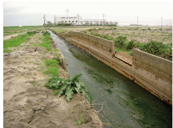
Fig. 19 排水路の浮上、傾き (地点番号 10) Uplifted or inclined drainage (No.10)
