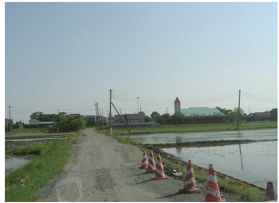
Fig. 69 道路陥没の状況（地点番号 2） Cave-in on the road (No.2)
