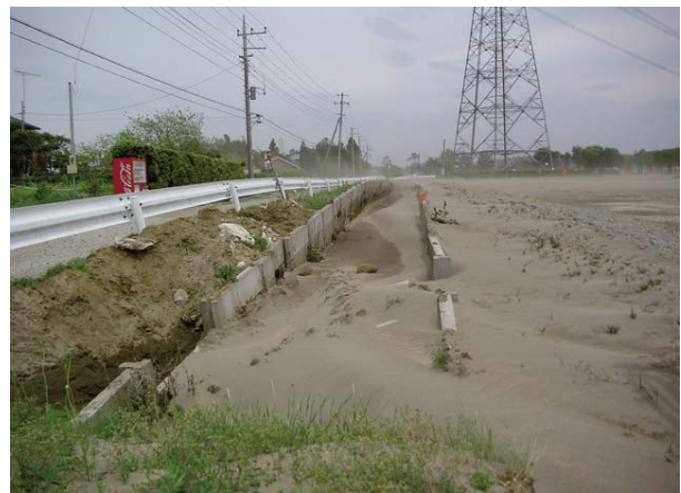
Fig. 35 噴砂で埋没した水路 (地点番号 2) Drainages Buried by liquefied sands (No.2)
