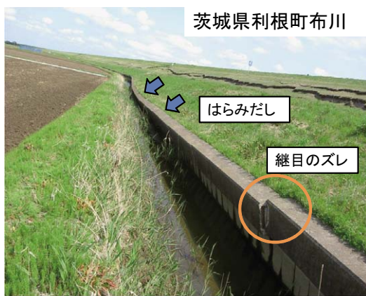
Fig. 51 コンクリート矢板型排水路の倒れ込み (川裏) Inclination of concrete pile drainages (on the side of the landward)
