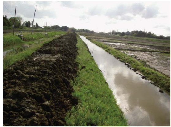
Fig. 58 侵入した土砂を排出することで応急復旧した排水路（地点番号 3） Restoration of drainage with discharge of the sands (No.3)
