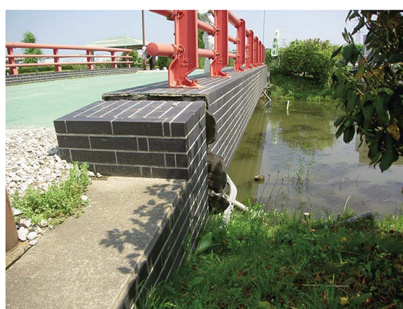
Fig. 39 橋の端部に発生した段差（地点番号 6） A relative gap between the bridge and ground (No.6)
