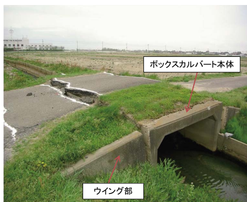
Fig. 21 ボックスカルバートに発生した段差（地点番号 11） A relative gap between the box culvert and ground (No.11)
