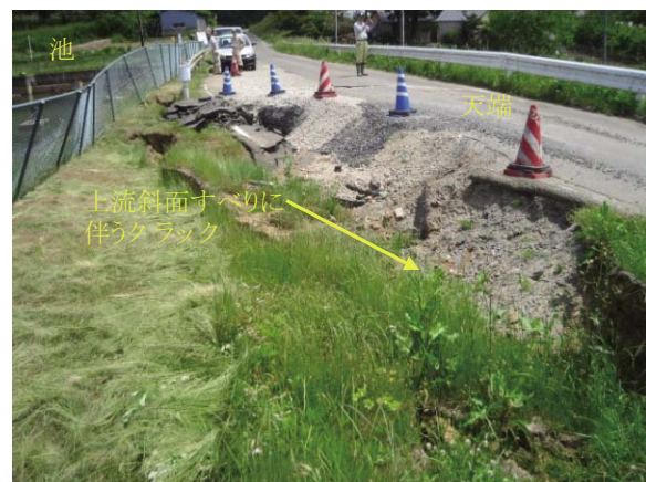
Fig. 31 北の内ため池上流斜面のすべり（右岸より撮影） Cracks on the crest of Kitanouchi dam (viewed from right abutment)
