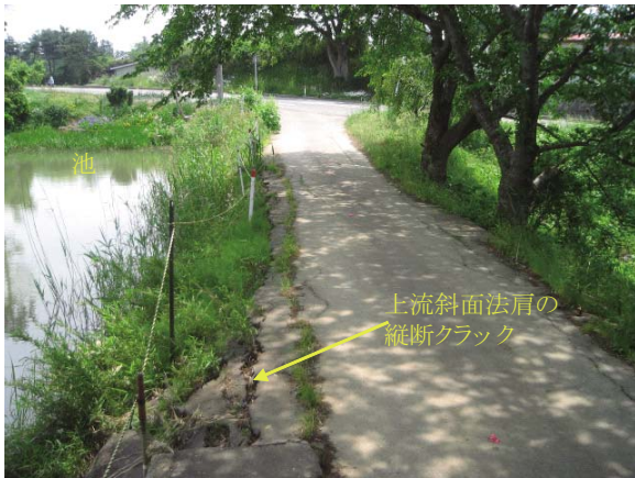
Fig. 41 松山池天端のクラック Cracks on the crest of Matsuyama dam
