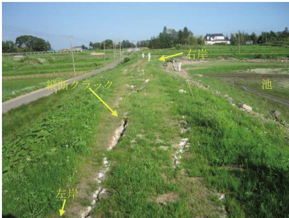
Fig. 16 大谷池天端の縦断クラック (左岸から撮影)
