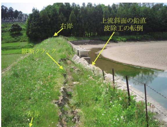
Fig. 12 堂前池の縦断クラック（左岸から撮影）
