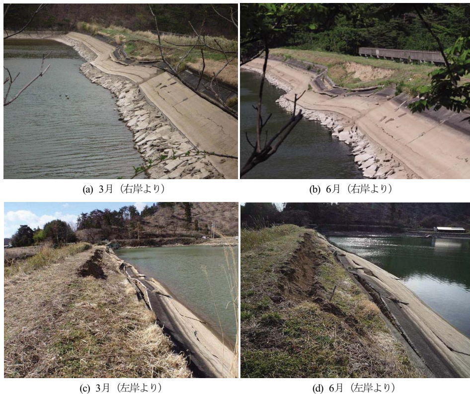
Fig. 53 岩根大池の上流斜面すべり形状の変化 Enlargement of the sliding failure on the upstream slope of Iwane-ooike dam
