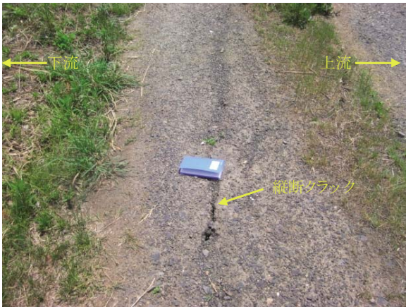
Fig. 37 十貫田池天端の縦断クラック A longitudinal crack on the crest of Jyukanda dam
