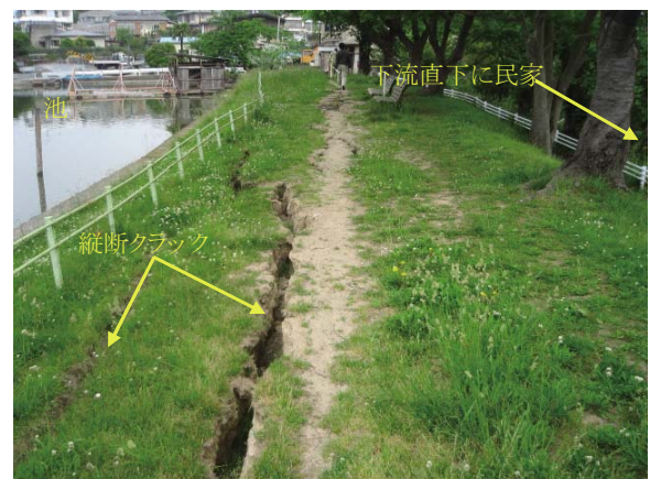
Fig. 22 酒蓋池天端の縦断クラック（右側に下流住宅地） Longitudinal cracks on the crest of Sakabuta dam
