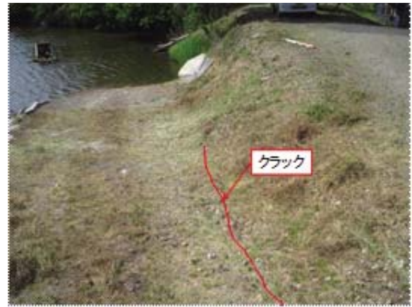
Fig. 42 荒池天端のクラック Cracks on the right side abut of Araiike dam
