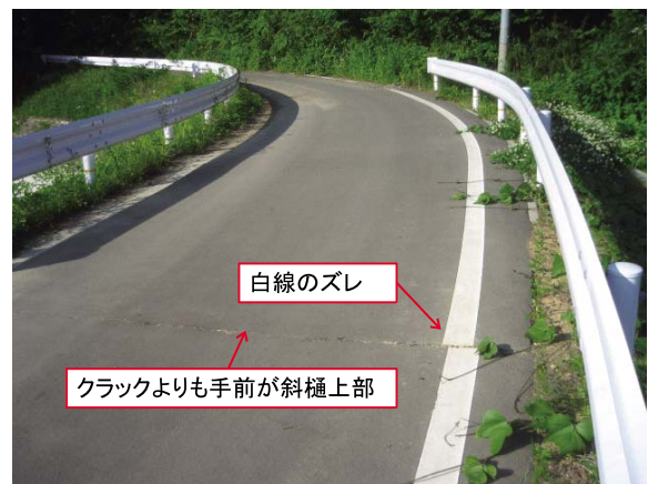
Fig. 44 家老内池天端舗装面の横断クラック Transverse cracks on the crest pavement of Karouchi dam
