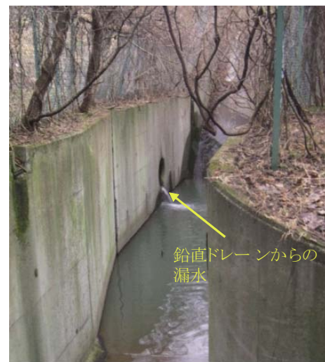
Fig. 21 細蕨ため池のドレーンからの漏水 Leakage through a pipe drain of Hosowarabi dam
