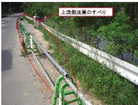
Fig. 28 菖蒲池上流斜面のすべり（左岸より撮影） Sliding on the upstream slope of Shobu dam
