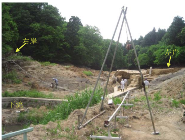
Fig. 7 決壊した中池（下流から撮影） Nakaike dam after breach (viewed from the downstream area)
