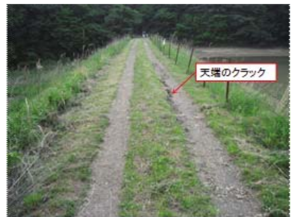
Fig. 26 三ツ池の天端縦断クラック (左岸より撮影) Longitudinal cracks on the crest of Mitsuike dam
