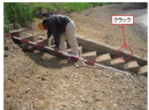
Fig. 40 二つ池上斜樋のクラック A crack on the inclined inlet pipe of Futatsu-ikeue dam
