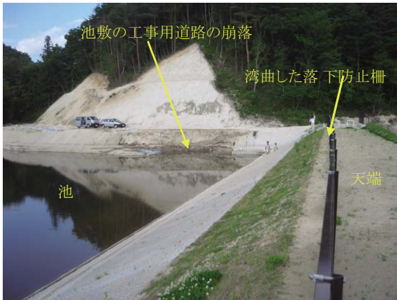
Fig. 45 八ノ口池の堤体と左岸池敷の崩落
