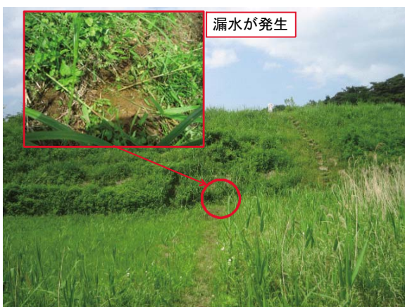
Fig. 13 荒池の漏水箇所
