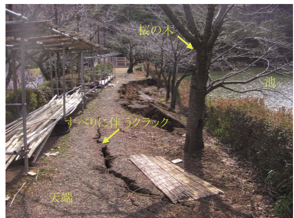
Fig. 19 蛇の鼻上ノ池上流斜面すべり (左岸上流側より撮影)
