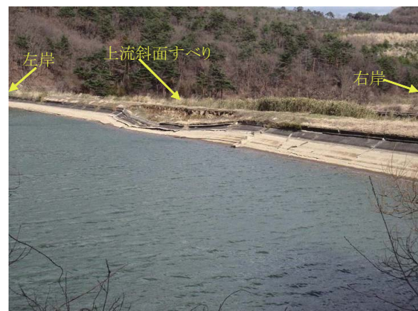
Fig. 14 岩根大池の上流斜面すべり（池側から撮影）
