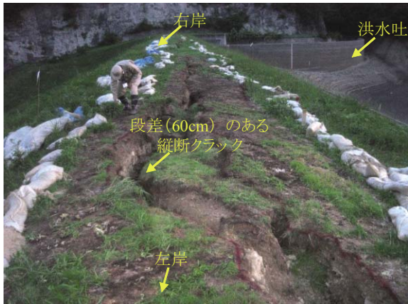
Fig. 9 三ツ森天端の縦断クラック (左岸から撮影) Longitudinal cracks on the crest of Mitsumori dam (viewed from the left side)
