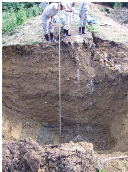
Fig. 51 クラックの確認状況 Measurement of a crack depth
