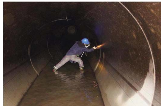
Fig. 37 不陸により滞水しているパイプ (矢吹南工区) Stagnant water due to unevenness of pipe at Yabukiminami subsection
