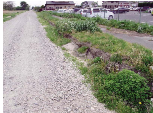
Fig. 48 パイプ敷設道路の沈下（東古宿分木工周辺） Settlement of road around Higasihuruzyuku division work
