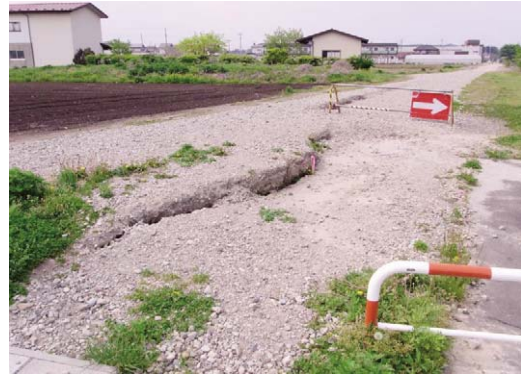
Fig. 41 パイプ敷設道路の亀裂 (矢吹北第1 排泥工周辺 (矢吹南工区)) Cracks on the road around Yabukikita No.1 blow off main pipeline
