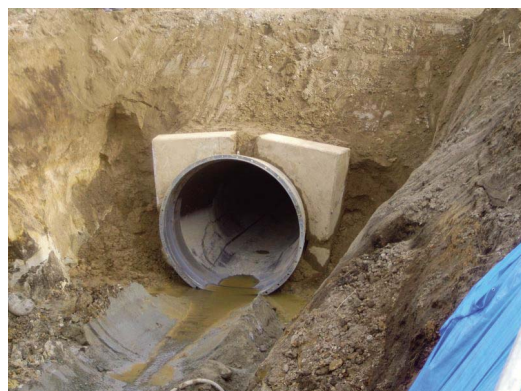
Fig. 42 スラストブロックの破損 (矢吹南工区) Damage to thrust block at Yabukiminami subsection
