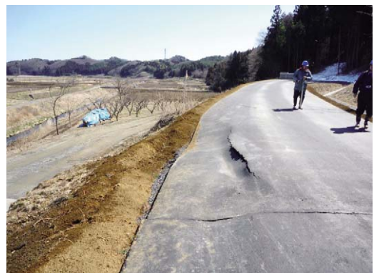
Fig. 17 パイプ敷設道路のすべり（大屋第 7 空気弁工周辺） Slope failure of the road above a pipeline around Oya No.7 air valve
