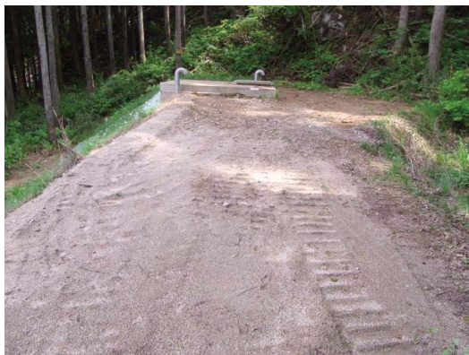
Fig. 14 大屋第 2 空気弁工 Oya No.2 air valve
