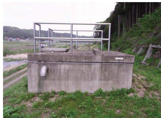
Fig. 11 下小屋第 5 空気弁工 Simogoya No.5 air valve
