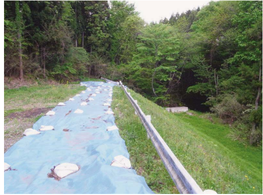
Fig. 20 パイプ敷設道路の亀裂 (信夫第9空気弁工周辺) Cracks on the road around Shinobu No.9 air valve
