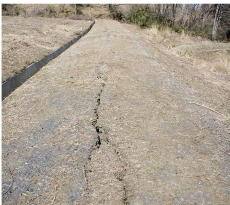
Fig. 19 パイプ敷設道路の亀裂 (信夫第8空気弁工周辺) Cracks on the road around Shinobu No.8 air valve
