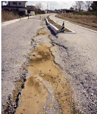
Fig. 45 パイプ埋戻し材料の噴砂（矢吹北第 5 排泥工周辺） Sand boil on a road around Yabukikita No.5 blow off
