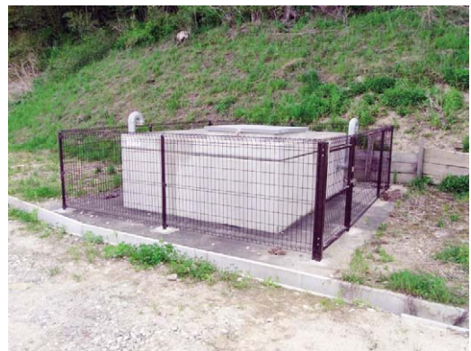
Fig. 15 大屋第 1 空気弁工 Oya No.1 air valve
