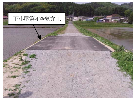
Fig. 10 下小屋第 4 空気弁工 Simogoya No.4 air valve
