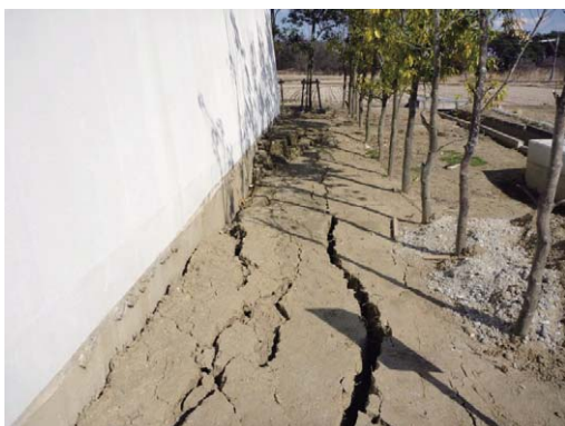
Fig. 51 路面の亀裂 (大池西合流工周辺) Cracks besides OikeNishi confluent structures
