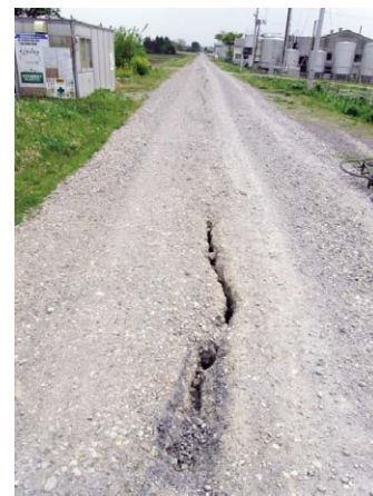
Fig. 49 パイプ敷設道路の亀裂（矢吹北第 8 空気弁周辺） Cracks on the road around Yabukikita No.8 air valve
