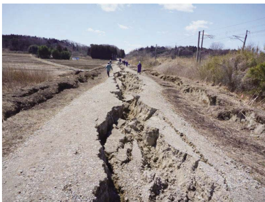
Fig. 34 パイプ敷設道路の亀裂 (矢吹南第 2 空気弁周辺) Cracks on the road around Yabukiminami No.2 air valve
