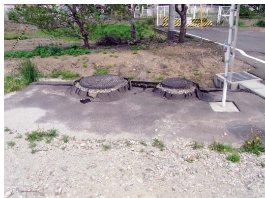
Fig. 43 矢吹北第1 排泥工のマンホール Manholes at Yabukikita No.1 blow off
