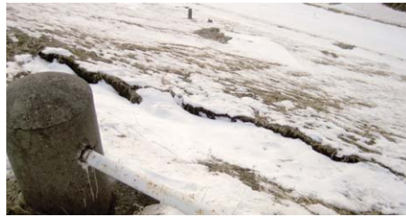
(b) 地震直後の段差クラック
