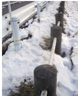
(b) ガードレール・旧高欄の沈下
