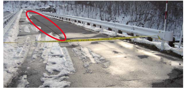
Fig. 32 堤頂道路アスファルトの舗装施工継目の離脱（右岸から見る）
