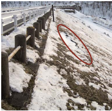
(a) 地震直後の段差クラック
