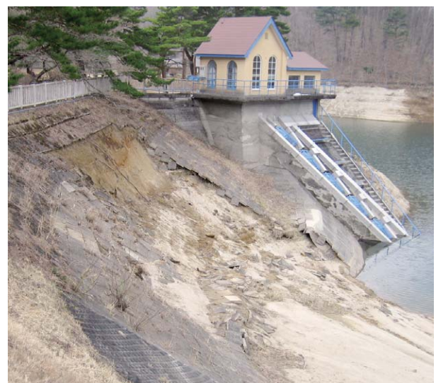
Fig. 46 右岸地山の法面保護ブロックの崩落 Collapse of slope protection at right abutment
