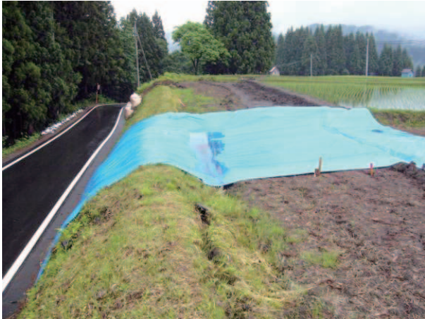
Fig. 30 畦畔法面の一部が崩落している水田 Collapse of levee slope
