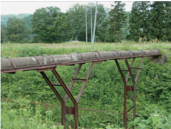
Fig. 21 鉄道上を跨ぐ水管橋 (変状なし) Water bridge over a railroad (not damaged)
