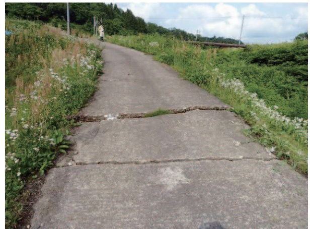
Fig. 17 コンクリート舗装道路の損傷 Damages to a concrete road
