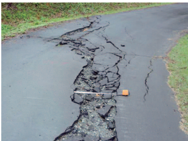
Fig. 32 アスファルト舗装の損傷状況 Damages to asphalt road
