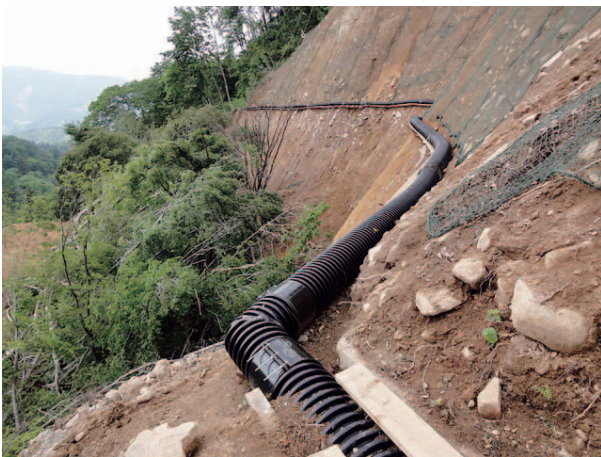
Fig. 3 コルゲート管による応急復旧状況 Emergency restoration with the corrugated pipe
