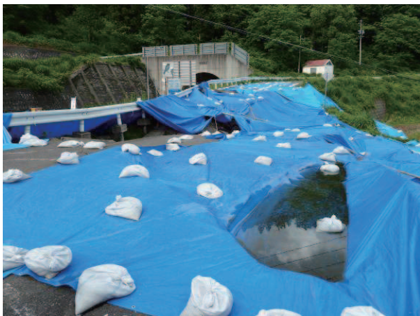
Fig. 14 国道と県道取付け部の大規模な損壊状況 Large-scale destruction of roads
