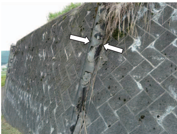
Fig. 15 ブロック積み擁壁の変位 Movement of walls
