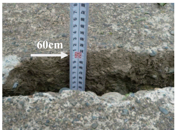
Fig. 18 深さ 60cm に達する亀裂 Crack reached a depth of 60cm
