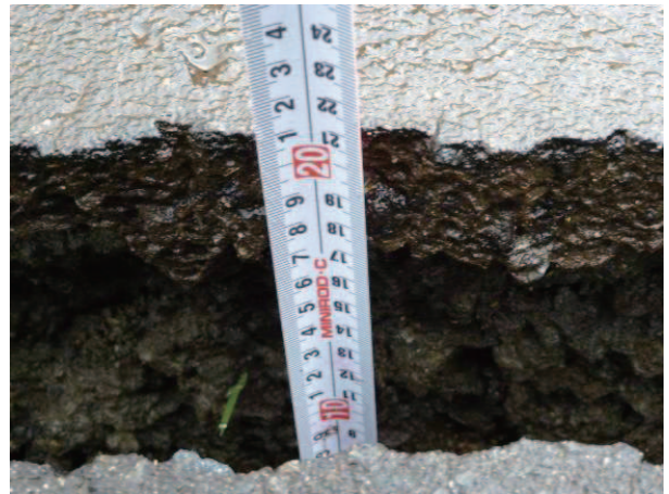
Fig. 33 深さ20cmに達する農道の亀裂 Crack reached a depth of 20cm
