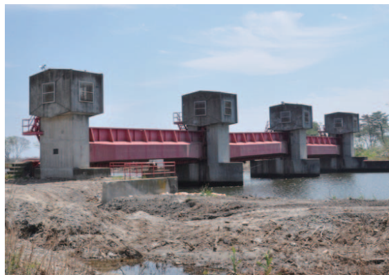
Fig. 6 大水門のレベル2の損傷（貞山堀水門） Level 2 damages of large tidal gates (Teizanbori G)
