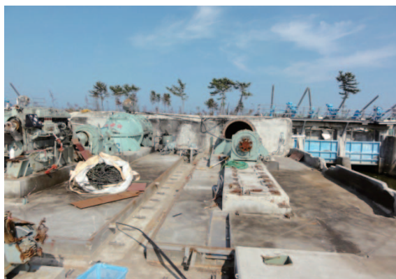
Fig. 2 排水機場のレベル1の損傷 (二郷堀排水機場) Level 1 damages of pumping stations (Nigouhori DPS(Drainage Pumping Station))
