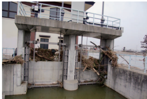
Fig. 13 小水門のレベル 4 の損傷 (下街道排水機場) Level 4 damages of small drainage gates (Shimokaidou DPS)
