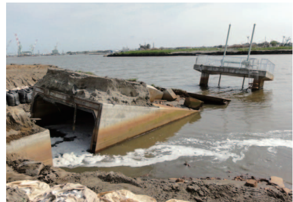
Fig. 8 小水門のレベル1の損傷（市営釜排水機場） Level 1 damages of small drainage gates (Kama DPS)
