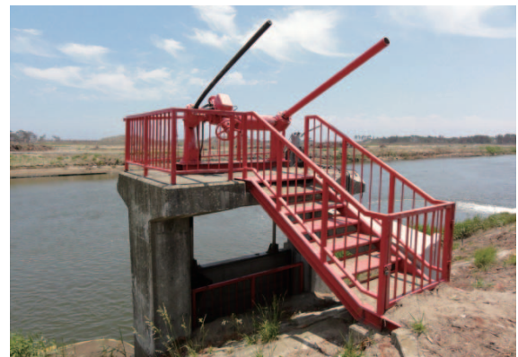
Fig. 9 小水門のレベル2の損傷（相野釜排水機場） Level 2 damages of small drainage gates (Ainokama DPS)
