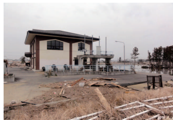
Fig. 4 排水機場のレベル3の損傷 (下街道排水機場) Level 3 damages of pumping stations (Shimokaidou DPS)
