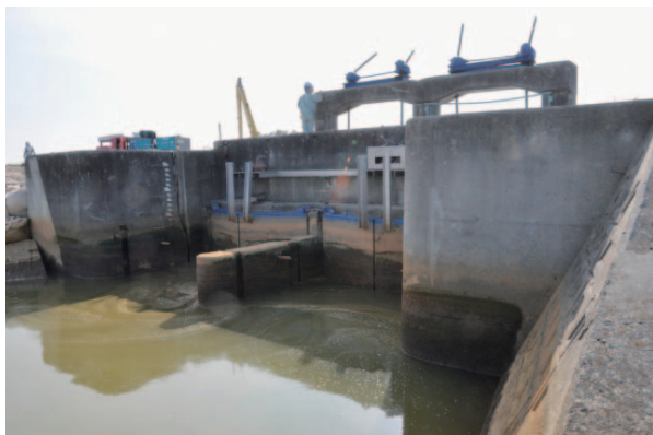
Fig. 12 小水門のレベル 4 の損傷 (大堀排水機場) Level 4 damages of small drainage gates (Ohori DPS)
