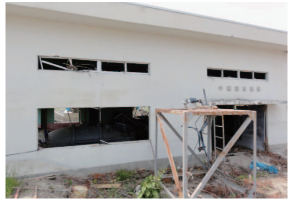
Fig. 3 排水機場のレベル2の損傷 (牛橋排水機場) Level 2 damages of pumping stations (Ushubashi DPS)
