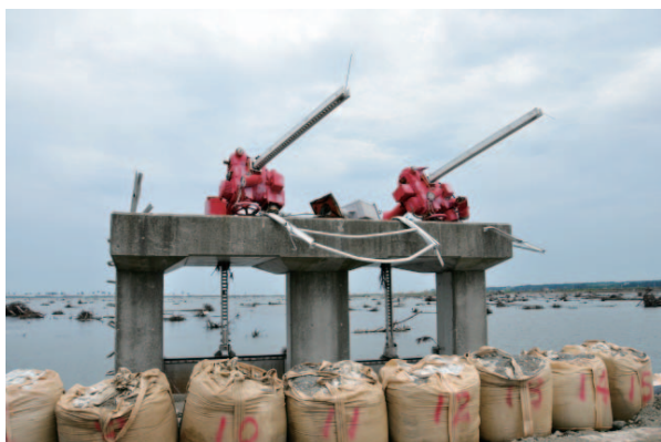
Fig. 11 小水門のレベル 3 の損傷 (新田排水機場) Level 3 damages of small drainage gates (Shinden DPS)
