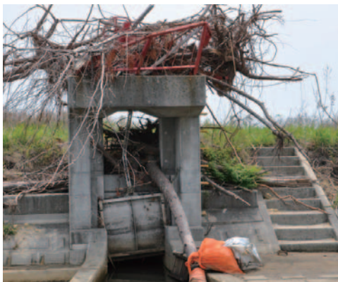
Fig. 10 小水門のレベル 2 の損傷 (坂元防潮水門付近) Level 2 damages of small drainage gates (Upstream point of Sakamoto tidal gate)
