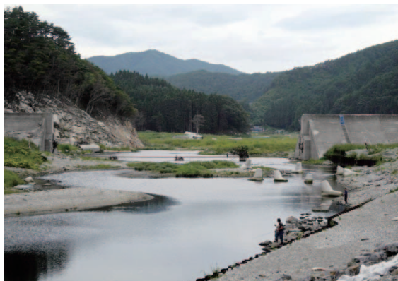
Fig. 5 大水門のレベル1の損傷（摂待水門） Level 1 damages of large tidal gates (Settai G(gate))
