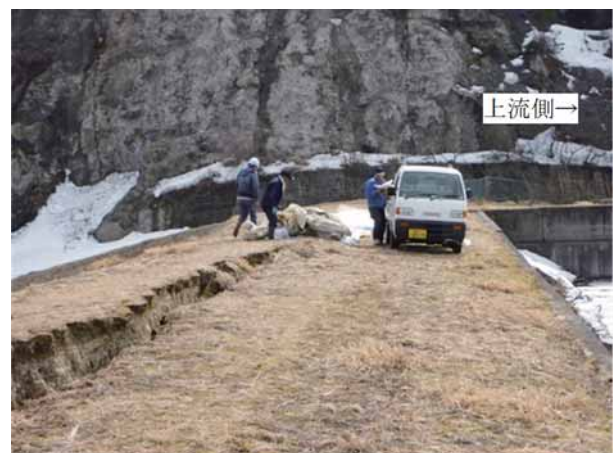
Fig. 2 三ツ森ため池被災状況 (2011 年 3 月 14 日) Damaged situation of the Mitsumori dam (2011/3/14)
