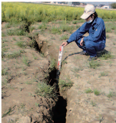
Fig. 5 隣接する水田の亀裂 Crack on neighboring paddy fields
