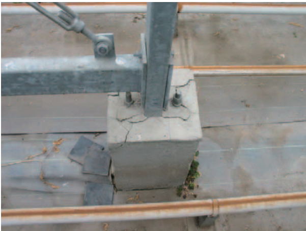
Fig. 32 フェンロー型温室 (①) の独立基礎に発生したクラック Cracks on the crest of the single footing of Venlo greenhouse (No. 1)
