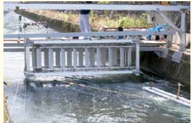
用水路に設置された小水力発電用の水車
