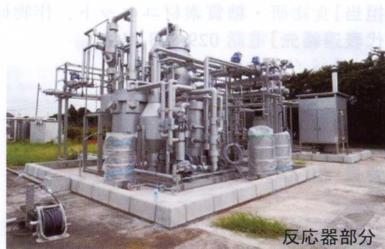
図2 実証プラント (設計製造能力：400 L/日)
