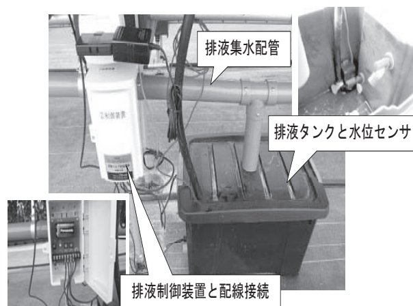
第6図 試験に供試した排液制御装置の外観
