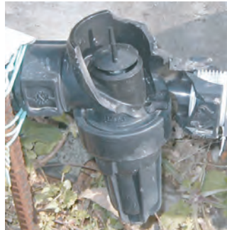
破損した減圧弁
