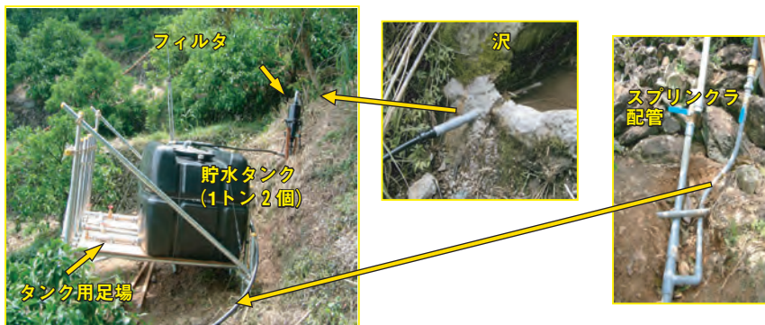
図3-1 沢と個人配管スプリンクラからの取水と貯水タンクおよびタンク用足場
