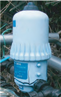
破損した液肥ポンプ
