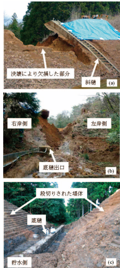
Fig.4 平成22年4月13日に決壊したため池堤体の被災状況： (a) 貯水側から見た堤体の欠損部；(b) 下流側から見たV字状に欠損した堤体； (c) ゆるみ部分を段切り掘削で除去した状況（復旧時に貯水側から下流側を撮影）
