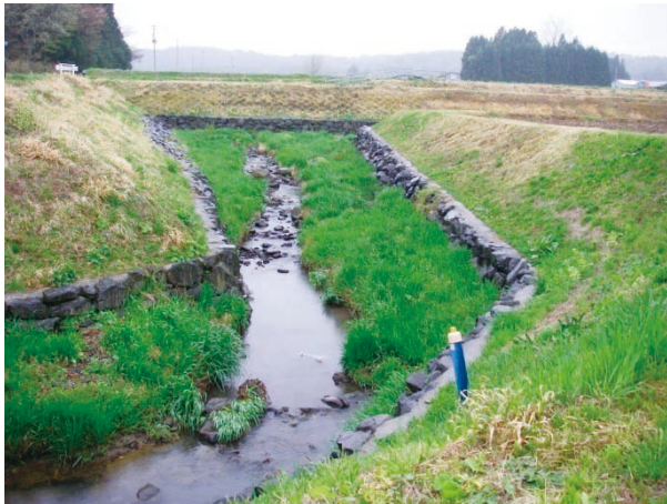
Fig.5 二面張り区間（急流落差工部） Wall lining zone (Rapid flow section)
