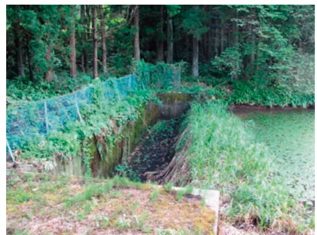
Fig.5 洪水吐流入口付近に繁茂する雑草 The weed in front of the spillway
