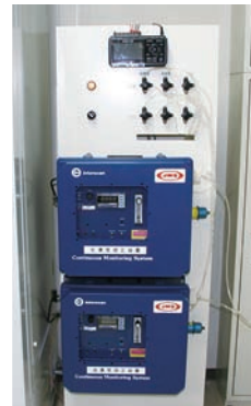
自動エチレングス濃度連続測定装置
