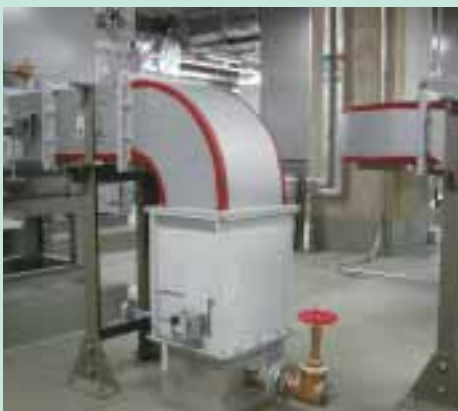
レベル3実験室ホルマリン燻蒸のための設備とダンパー
