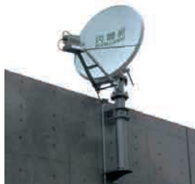
防災研究棟屋上に取り付けられた中央防災無線網のアンテナ
