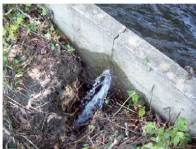
図1 目地部からの漏水状況
