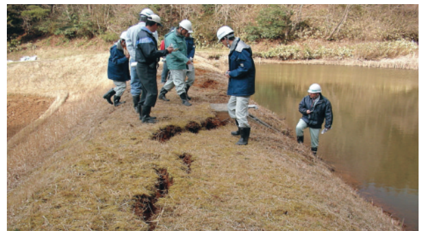
—ため池堤体に発生した割れ目の危険度を診断—
