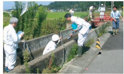
写真 地震で歪んだ水路を調査（柏崎市） （企画管理部防災研究調整役 小林宏康）
