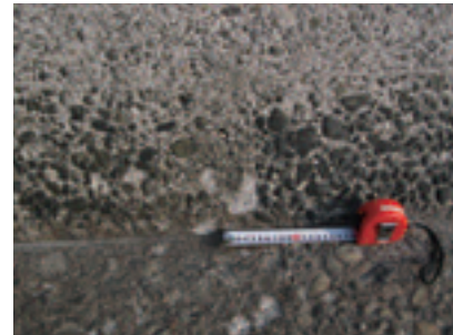
写真 1 水路の摩耗の状況
