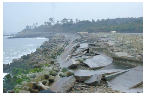
写真 高潮の激化に伴う堤防破壊
