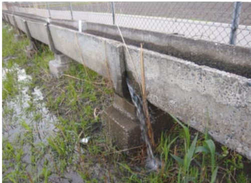
写真1 末端圃場で様々な問題を起こす水路目地からの漏水
