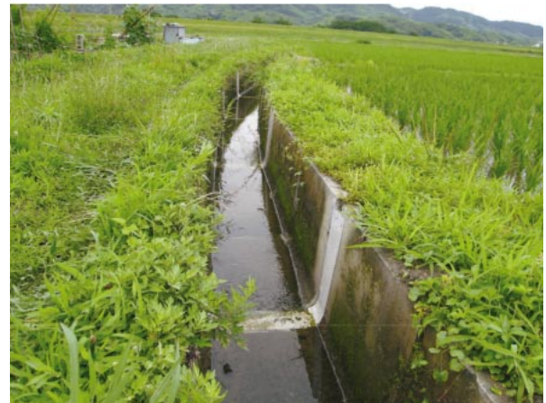
写真3 施工後の状況（2008年11月に補修したもので、2009年6月においても良好な状態でした）
