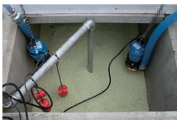
図3 養豚農家に設置した窒素除去性能実証用施設（通水前の状況）
