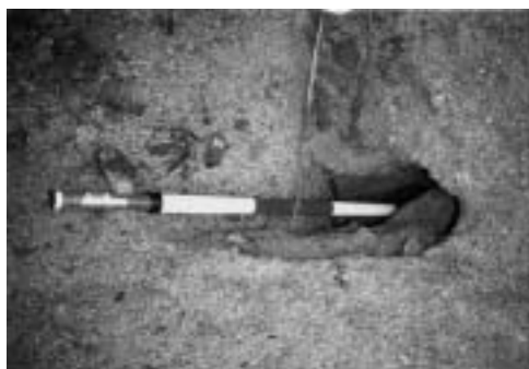
Photo 3-4 下流斜面に発見された穴 A hall on the downstream slope
