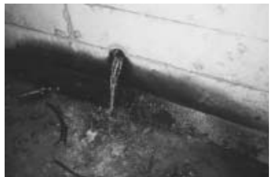
Photo 3-24 洪水吐水路排水孔（点 I）からの漏水 （写真は貯水位が洪水吐クレストより約 20cm 下の状態のときに撮影） Leakage from a drain pipe on the spillway (Point I)
