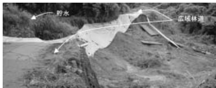
Photo 4-5 青野堤ため池の下流斜面すべり(右岸側地山より撮影) Sliding on the downstream slope of Aonotutumi dam
