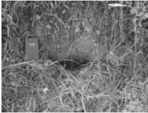
Photo 3-7 点Bのパイピングホールの下流斜面の出口 Exit of piping hall on downstream slope at point B
