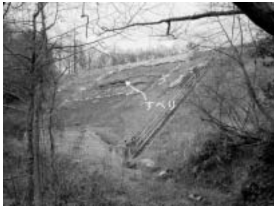
Photo 4-6 大溜1号の被災状況 (左岸下流側より撮影) Ootameichigo dam (viewed from downstream)
