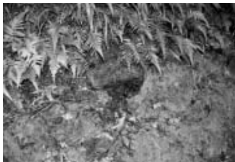
Photo 3-2 上流斜面のパイピングホール入口 An entrance of piping hall on the upstream slope
