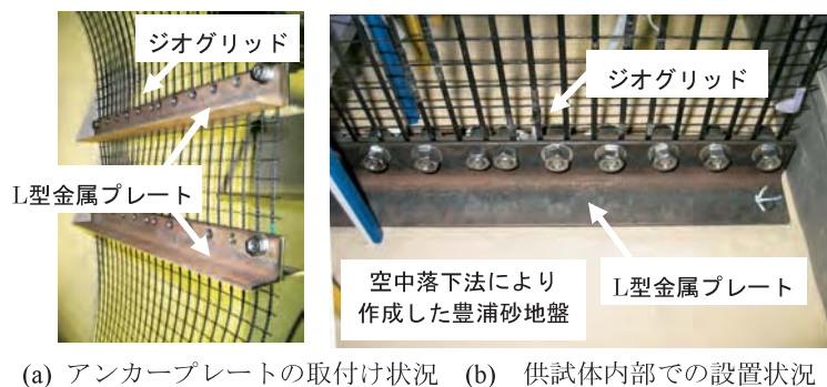
Fig. 92 アンカープレートを取付けた補強材の設置状況 (V6000 を使用) Installation of reinforcement attached to anchor platens
