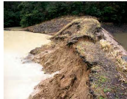
Fig. 269 2007年能登半島地震被災した平田ため池堤体のすべり崩壊状況(毛利ら, 2007より引用) Sliding failure of Hirata reservoir embankment with the 2007 Noto Peninsula earthquake
