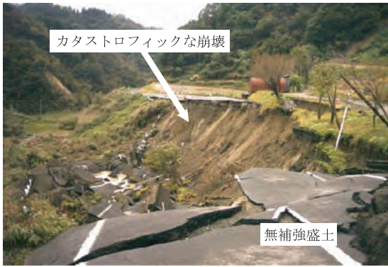
(a) 国道341号道路盛土の崩壊 (筆者撮影)
