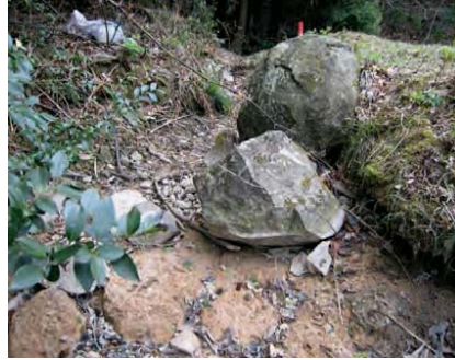
Fig. 270 排水能力が不十分な洪水吐の断面 (毛利ら, 2007 より引用) Existing old spillway with inefficient drainage capacity
