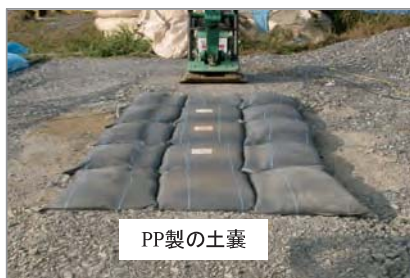
Fig. 145 重量 350kgf 級の現場用プレート型振動締め機による土嚢の転圧方法 Compaction of soil bags using a field vibratory compactor at a weight of 350 kgf
