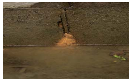
継目からの漏水
