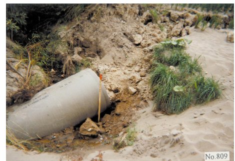
写真1 曲部のパイプの被害状況
