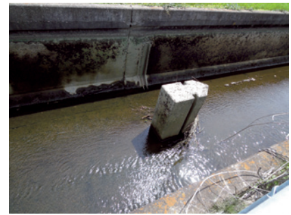
Fig.18 沈下した水路に敷設された 角落とし構造物 The intake weirs installed in subsidence canals to keep water level
