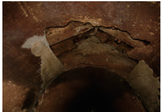
Fig.10 天端の崩落（森ら，2012） Collapse of irrigation tunnel lining
