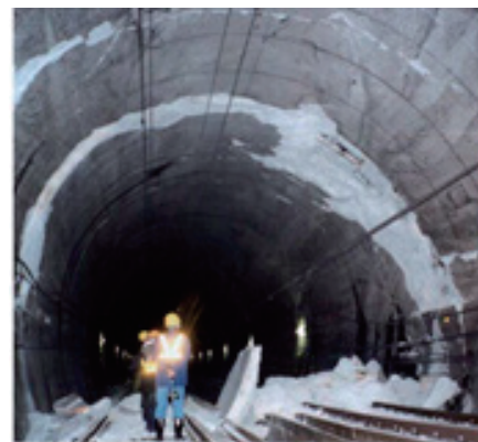
Fig.4 新潟県中越地震による魚沼トンネルの損傷（朝倉ら、2009）
