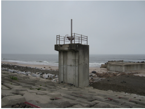
Fig.6 遠隔監視が望まれる海側のゲート A tidal gate adjacent the sea requiring remote supervision
