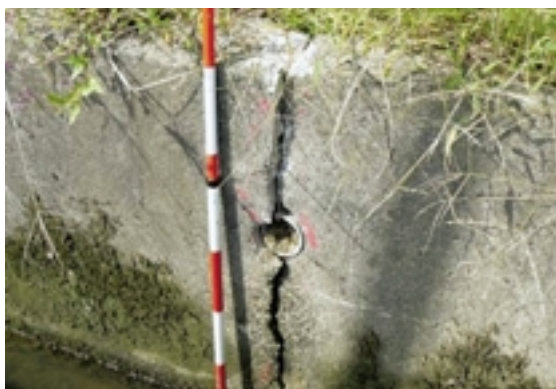
Fig.43 現場打ちコンクリート三面張水路における水抜孔付近のひび割れ Cracking at a weep hole in a cast-in-place concrete canal
