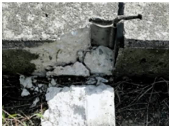
Fig.20 水路側壁目地部外側におけるコンクリートの剥落・鉄筋露出 Stripping of concrete and exposure of reinforcing on the outer side of a canal joint
