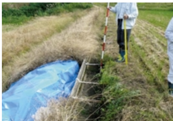
Fig.46 水路敷の崩落により宙ぶり状態のベンチフリューム A suspended bench flume after subsidence under a canal
