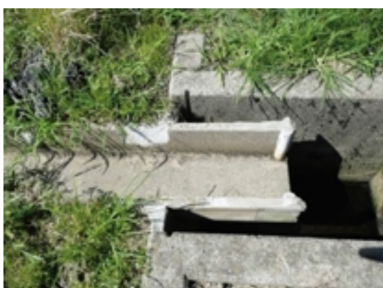
Fig.18 分水柵におけるベンチフリュームの突出 Protrusion of a bench flume at a diversion device
