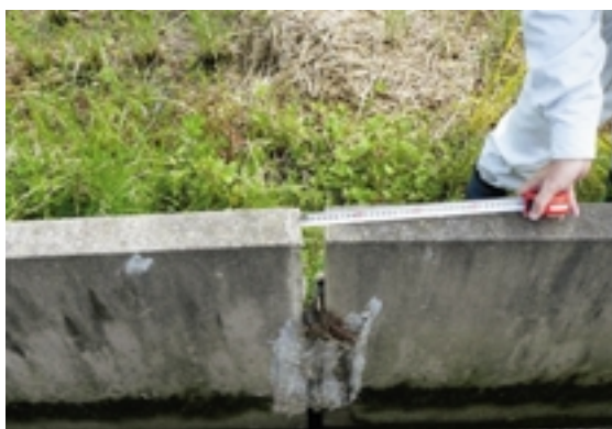
Fig.42 排水フリュームにおける目地の開き Expansion of a joint in a drainage flume
