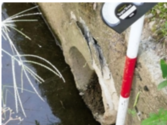
Fig.17 排水フリュームにおける流入管の突出 Protrusion of the inflow tube at a drainage flume
