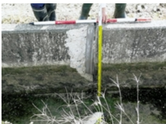
Fig.19 水路側壁目地部内側におけるコンクリートの剥落 Stripping of concrete on the inside of a canal joint
