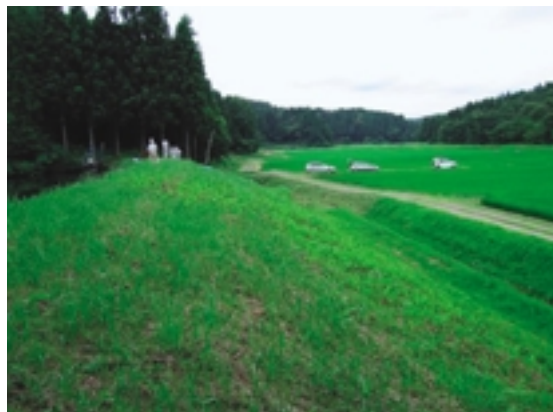
Fig.14 下流法面の亀裂とすべり（東堤）
