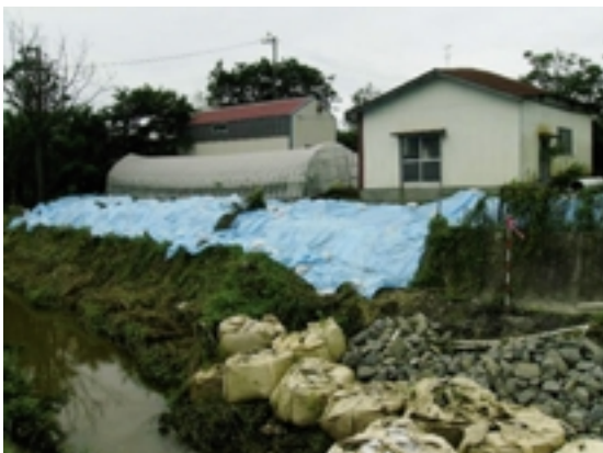
Fig.2 地山が崩壊して水路を塞き止めている状態 Drainage canal dammed by slope collapse
