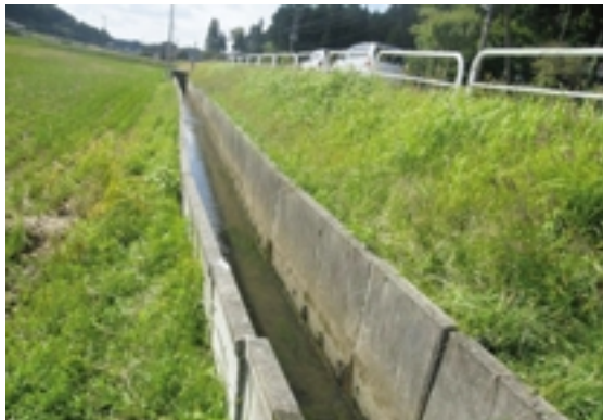
Fig.41 水路脇法面の押し出しによる排水フリューム側壁の変位
