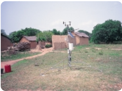
写真1：村の中心に設置した気象観測ロボット
