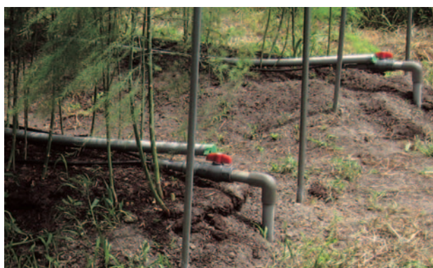
写真6 散水管を点滴チューブへ置き換えたところ 万一、導入した拍動灌水装置が機能しなかった場合に備えて、従来の散水灌水に戻ることができるようにしてある。
