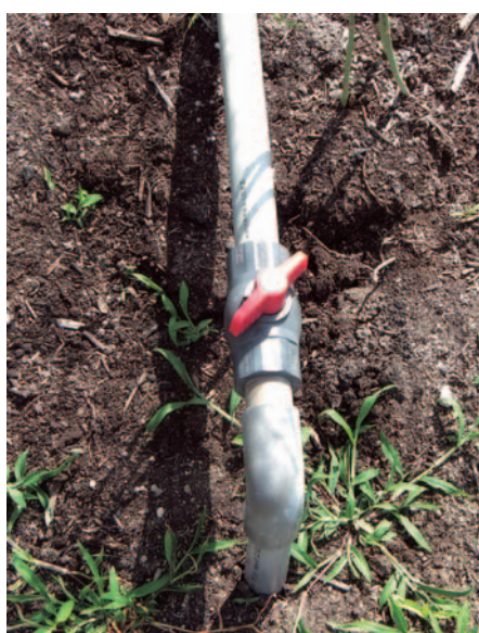
写真5 ボールバルブによる散水量の調節 バルブの開き具合で散水量を調節していた。
