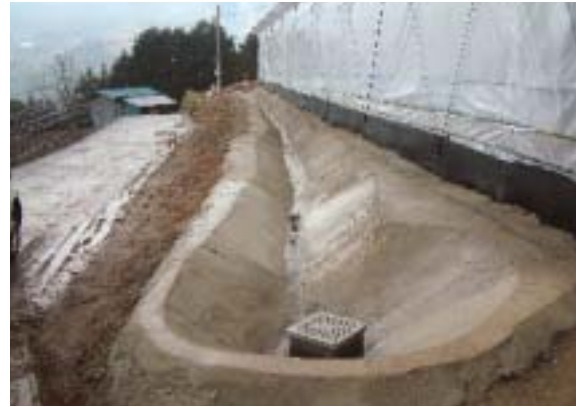
写真2 ハウスの貯水型排水路
