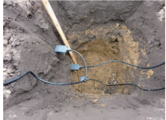
Fig. 3 誘電式土壌水分センサーの設置状況 Installation of dielectric soil moisture sensors
